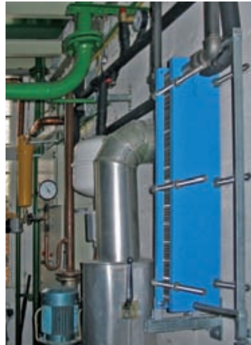
Rückgewinnung durch Wärmetauscher mit Vorwärmung für Kesselwasser
